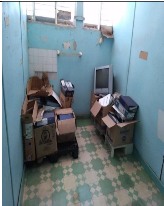
Fotografía 19 Fondo 2, Archivo Central, piso 2, documentación en cajas grandes, sin organización, entre mobiliario externo y riesgo de luz y agua.
